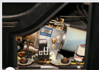
1 Die Hydraulikpumpe der Dachbetätigung ist problemlos, Undichtigkeiten sind selten
