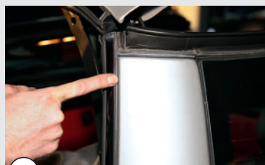
5 Die große Dichtung rund um den Heckscheibenrahmen verdeckt oft ernste Rostschäden
