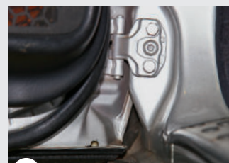
14 Türunterkanten rosten nur, wenn die Abflusslöcher verstopft sind und sich Wasser sammelt
